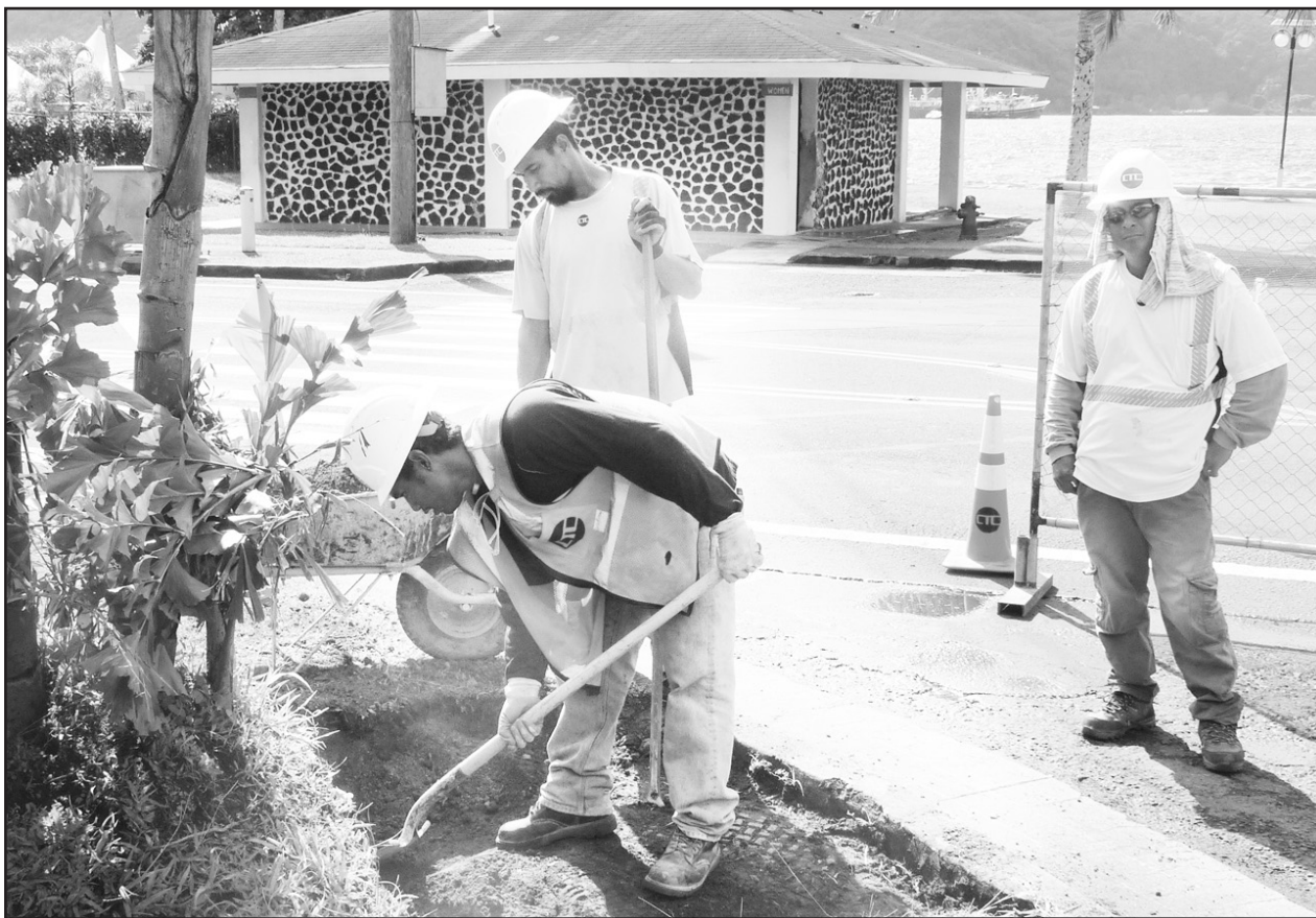
O se va'aiga lea i le toe siakia o "Man Holes" i lumafale o le DOE i Utulei e le aufaigaluega a le ASPA, itu o le Suavai Lafoa'i. [ata: Leua Aiono Frost]
